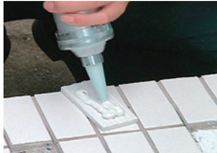
⑬：貼替えタイルの裏面に接着材を塗布し、下地側へ貼り合わせる
